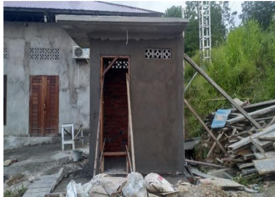
Gambar 10. Hasil akhir Dari Pekerjaan Plesteran Dinding, Pemasang Roster dan Kusen Pintu Toilet
